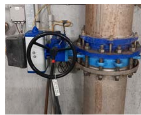
Vanne d'alimentation biofiltres
