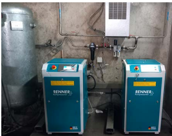
Deux compresseurs d'air et sécheur d'air
